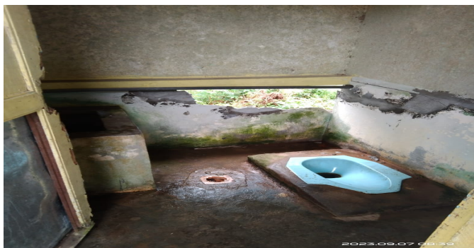
Gambar 5. Ruangan wc guru dan murid SDN 50 Kayu tunu
